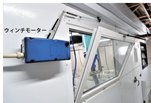
非常窓 (開いた状態)
